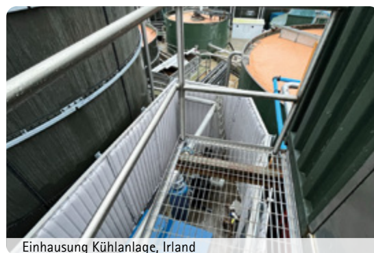
Einhausung Kühlanlage, Irland
