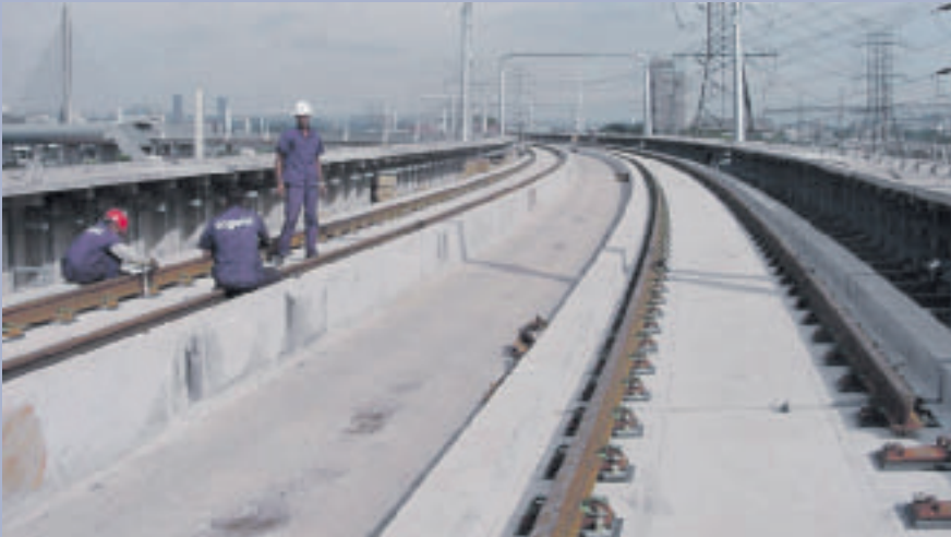
Bild 8: USM® Gleisbettmatten auf freier Strecke unter Beton
